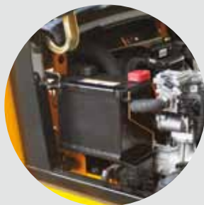
Schwenkbar installierte Batterie
